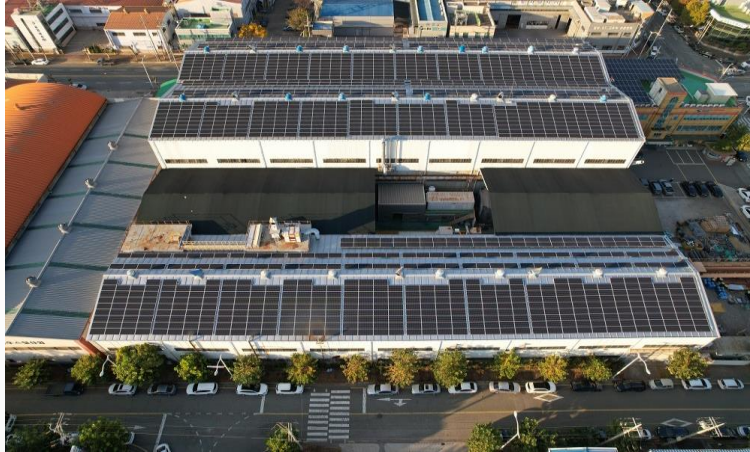
● 성일터빈(0.67MW) – 부산 강서구
