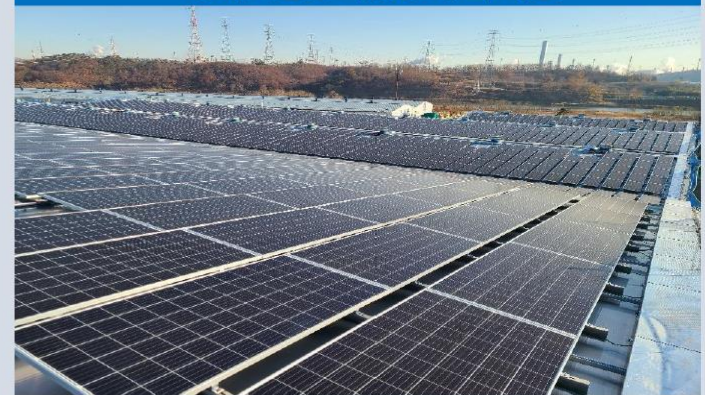
동서발전형 태양광 구축 사진
